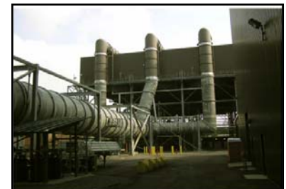
HRSG UNIT Athens Generating Plant, NY
